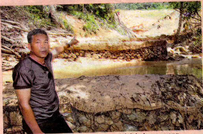
ABD. AZIZ menunjukkan kawasan projek lebuh raya yang didakwa menyebabkan banjir lumpur di Kampung Melayu Tambahan, Rawang semalam.
