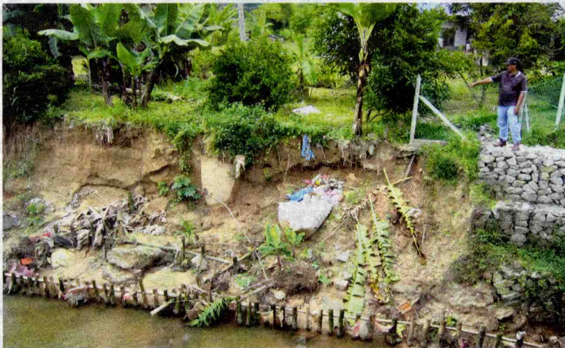
WAHAB menunjukkan masalah hakisan di tebing sungai yang terletak kira-kira 20 meter dari rumahnya di Rembau semalam.
