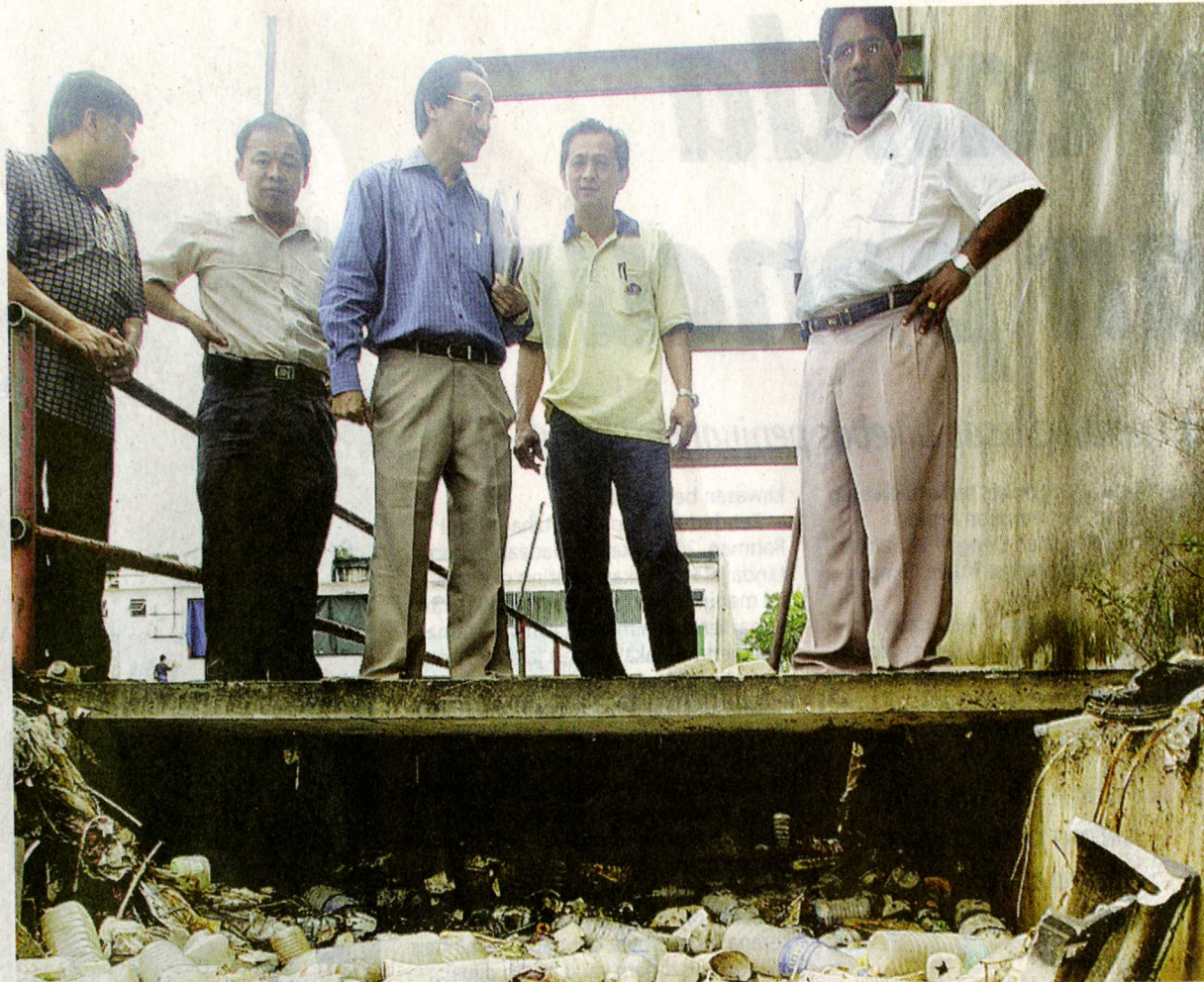
TERSUMBAT: Yap (tengah) sedang berbincang dengan pengusaha kilang lain berikutan kejadian banjir kilat melanda kawasan Perindustrian Kajang, akibat sampah sarap.
