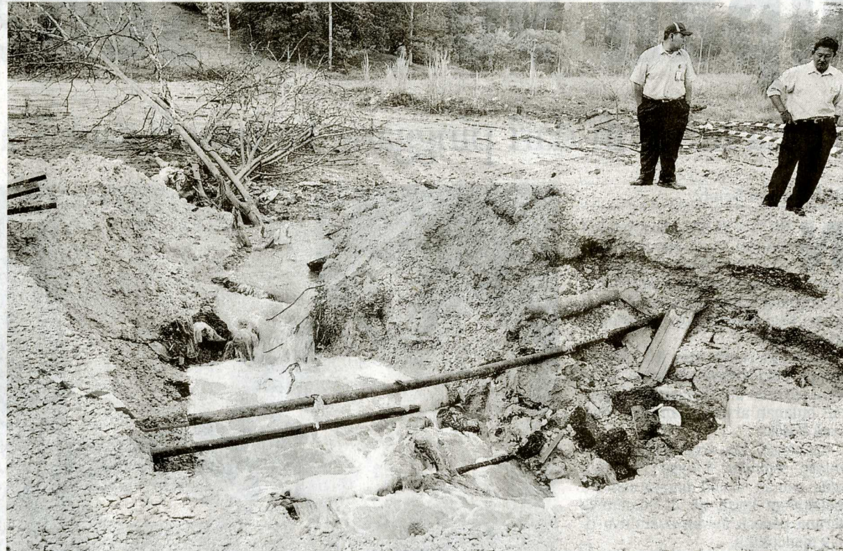
SILAP PERKIRAAN: Jalan dekat kuari Sungai Long pecah berikutan leachate dari bekas tapak pembuangan sampah.
