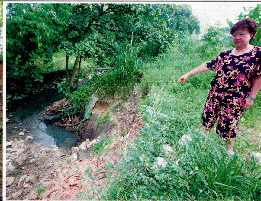
KELLY Teh menunjukkan hakisan tebing yang dibimbangi mengancam keselamatan penduduk berhampiran.
