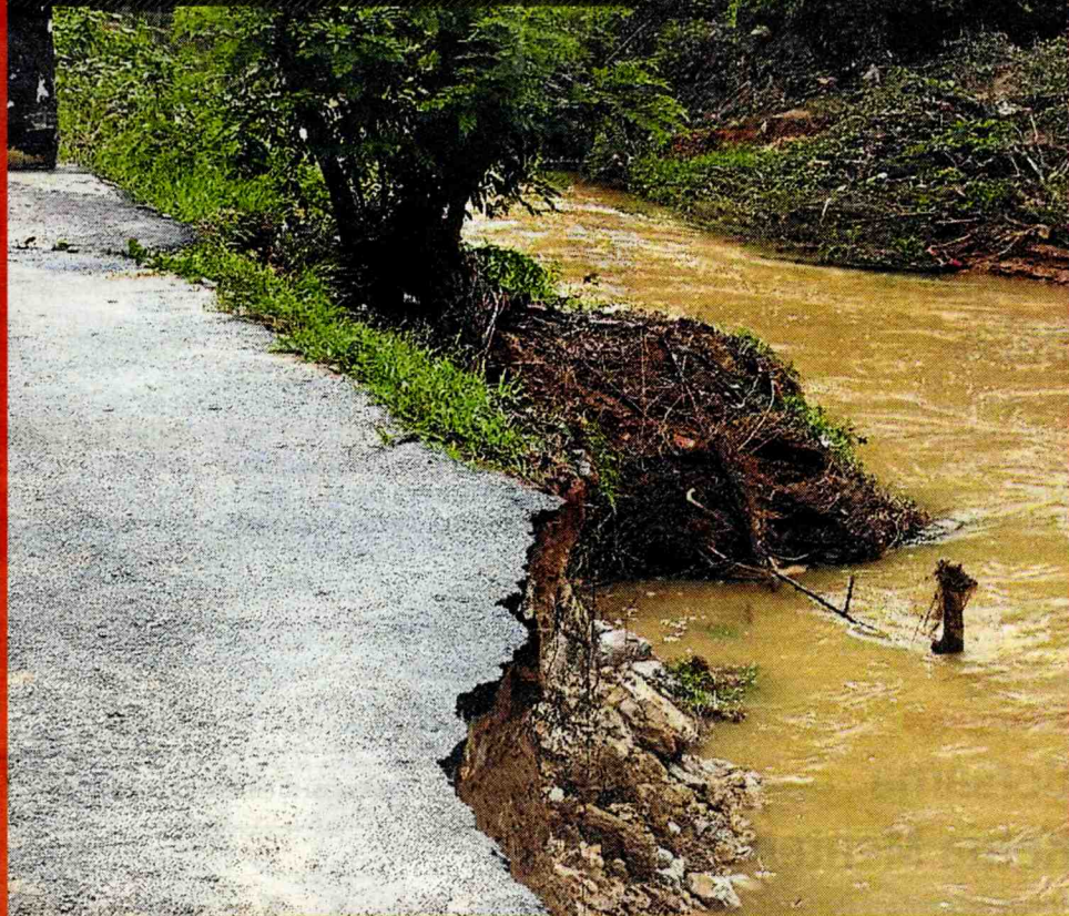
Jalan yang menjadi penghubung di kampung Jimah Lama turut runtuh akibat banjir kelmarin.
