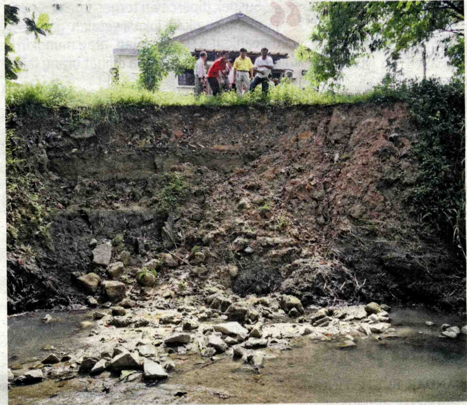
Kok Eng bersama penduduk meninjau kawasan Taman Megah yang mendakwa ada hakisan tanah yang boleh membahayakan nyawa, semalam.
