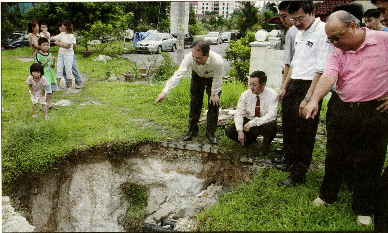
TEONG LOK menunjukkan mendapan tanah didakwa akibat banjir lumpur yang kerap berlaku di Taman Segambut Maju.
