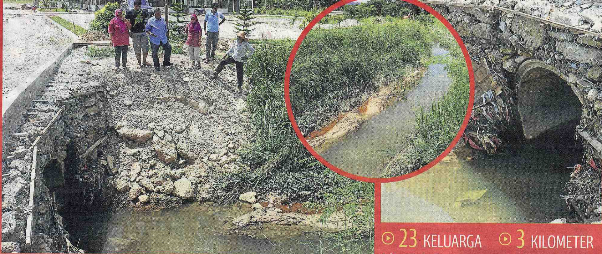
Keadaan sistem saliran Sungai Lemas yang tidak dinaik taraf hingga mengakibatkan banjir di Jalan Nazir Kampung Sungai Ramal Dalam.
