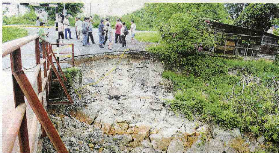
Keadaan tebing runtuh yang semakin serius menyebabkan ia tidak boleh dilalui penduduk.
