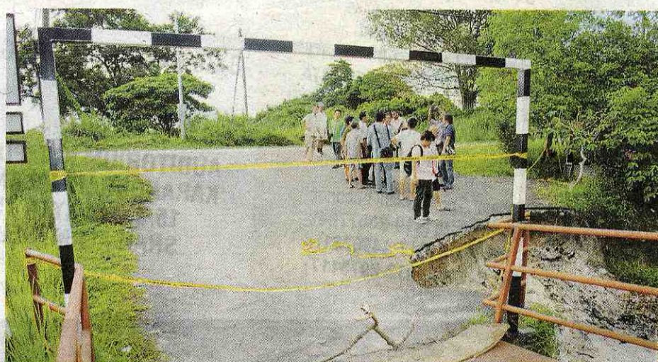
Tali kuning diikat pada palang jambatan kerana berbahaya kepada pengguna.
