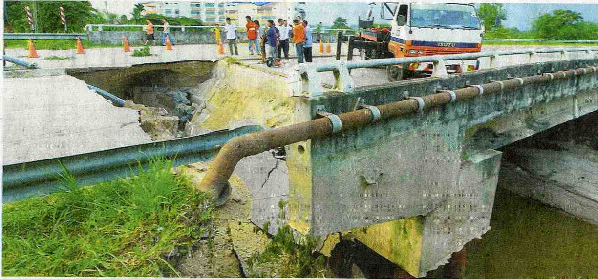
RUNTUHAN jambatan di Kampung Batu 9, Sungai Rasau Pulau Meranti akibat daripada hakisan air sungai berhampiran terpaksa ditutup bagi mengelakkan bahaya kepada pengguna jalan berkenaan di Sepang, Selangor, semalam.
