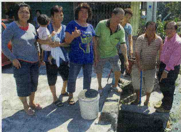
Penduduk menunjukkan saliran perparitan yang didakwa pecah dan tidak mengalirkan air dengan sempurna.
