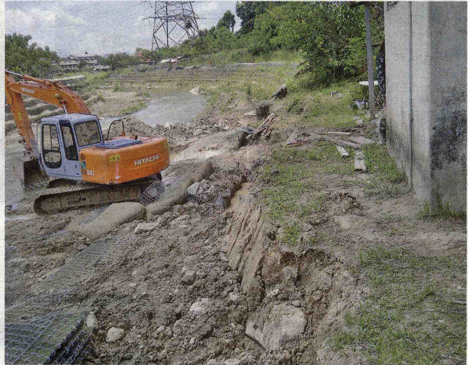
Kerja-kerja mengorek sungai yang menyebabkan tebing sungai runtuh.
