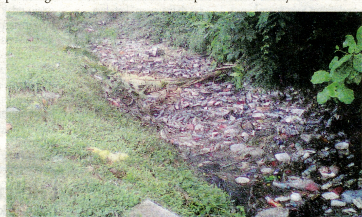
Air tidak dapat mengalir sempurna antara punca banjir di Rantau Panjang.
