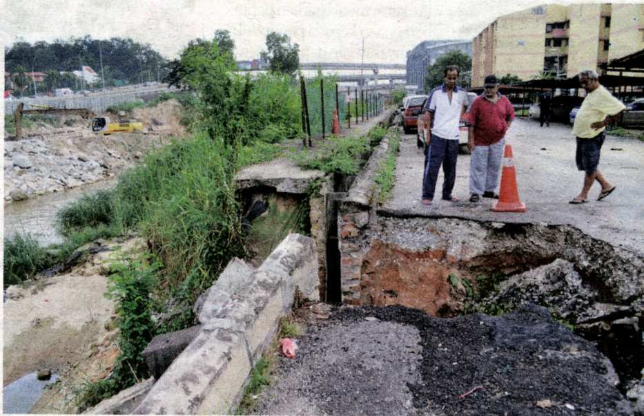
Lubang sedalam tiga meter berpunca daripada runtuhan tanah tebing sungai di Jalan AU3/1, Keramat.
