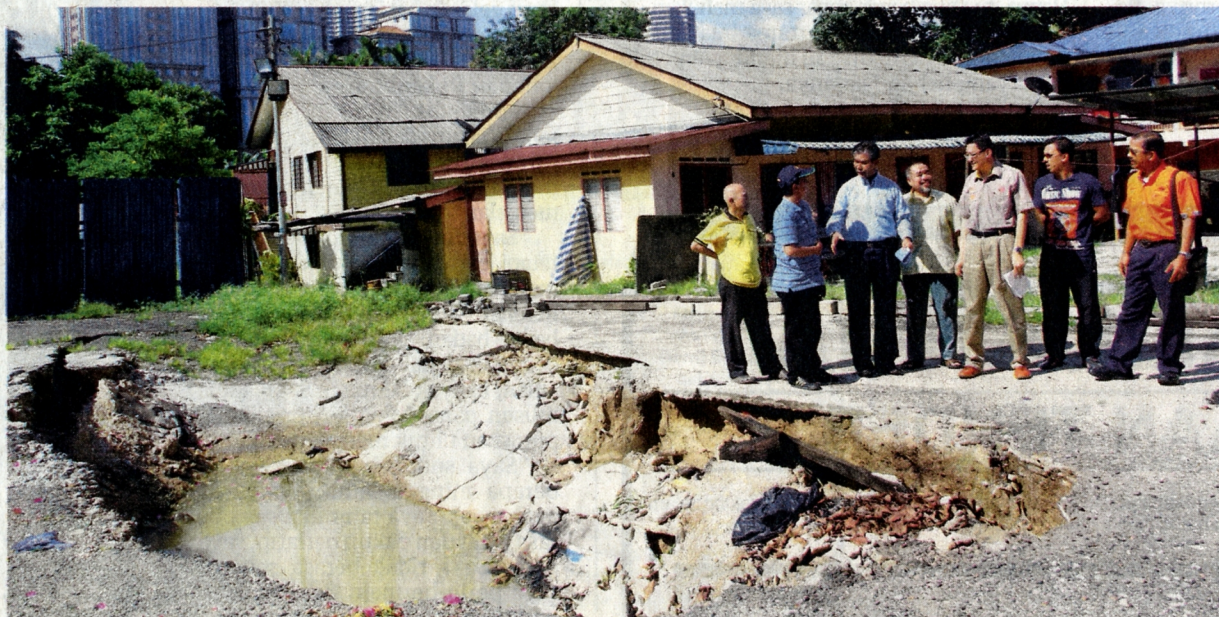
TANAH mendap yang berlaku di Kampung Pindah, Kampung Baru, Kuala Lumpur menyebabkan kawasan sekitarnya tidak stabil dan memaksa DBKL mengeluarkan notis mengosongkan rumah kepada penduduk.
