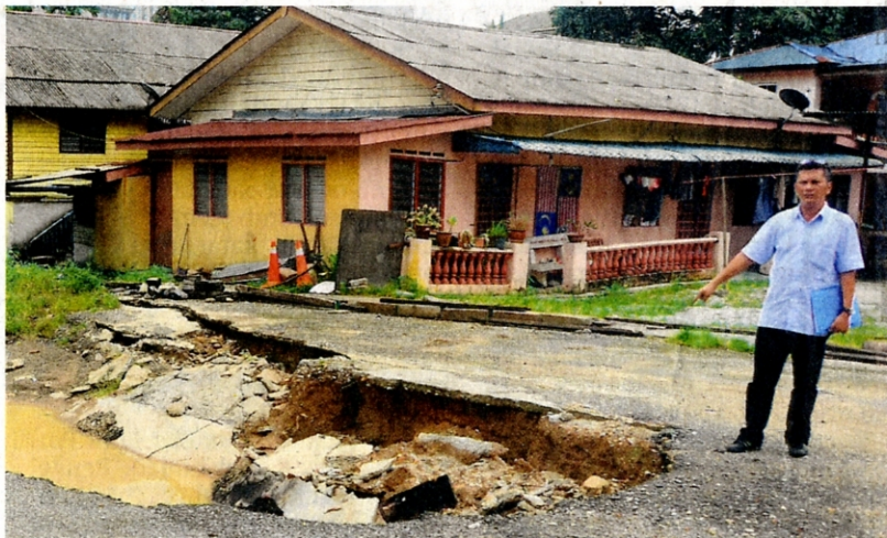
ABDUL Ghani Mohd. Noor menunjukkan keadaan tanah mendap yang terjadi di kawasan rumah penduduk Kampung Baru, Kuala Lumpur, semalam.
