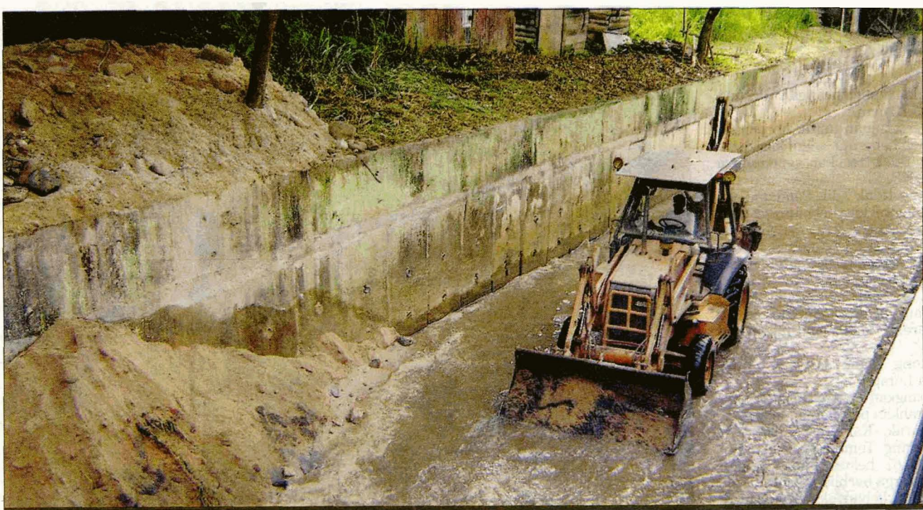
JENTOLAK mengorek pasir di Sungai Temiang dalam Program Pembersihan Sungai Temiang bagi mengindahkan bandar Seremban.
