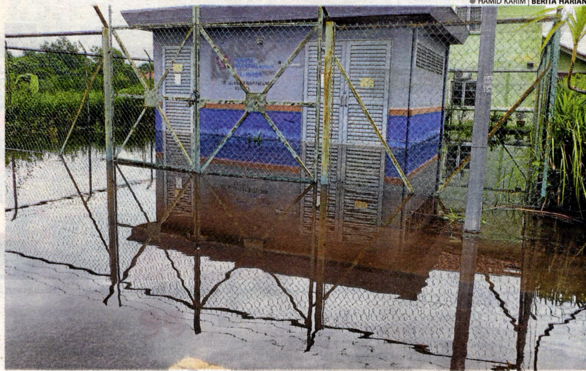
PENCAWANG elektrik di Seksyen 32, turut digenangi banjir kilat, kelmarin.
