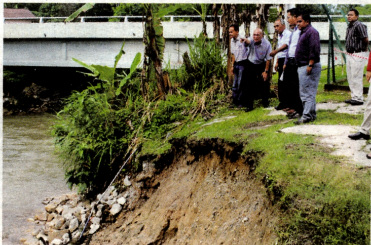
Nor Hisham (dua, kiri) melihat tebing sungai berdekatan Jambatan Kampung Jawa yang runtuh akibat hakisan.
