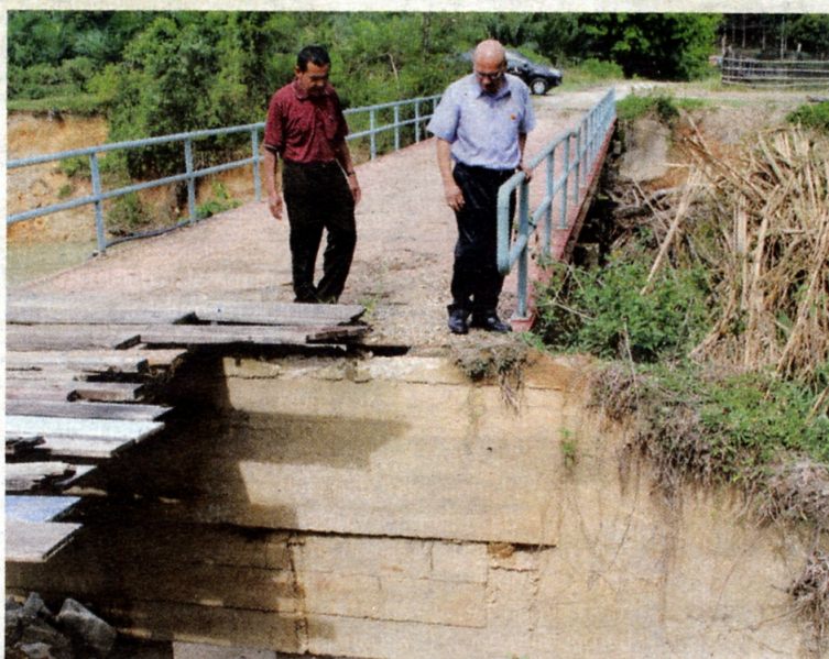
Nor Hisham (kanan) ditemani Nur Salim melihat keadaan Jambatan Belia yang terputus akibat hakisan.
