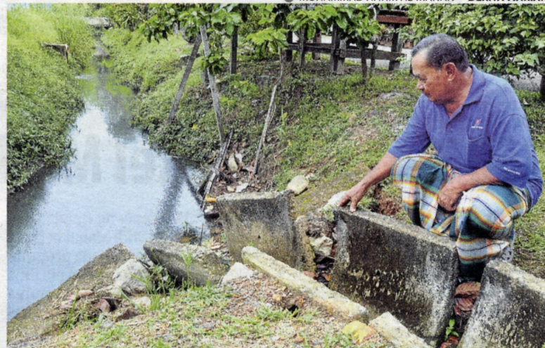
CHE MAT melihat kesan hakisan pada tebing parit bersebelahan rumahnya dan seringkali menyebabkan banjir kilat di Kampung Telok, Bukit Beruang, Melaka.
