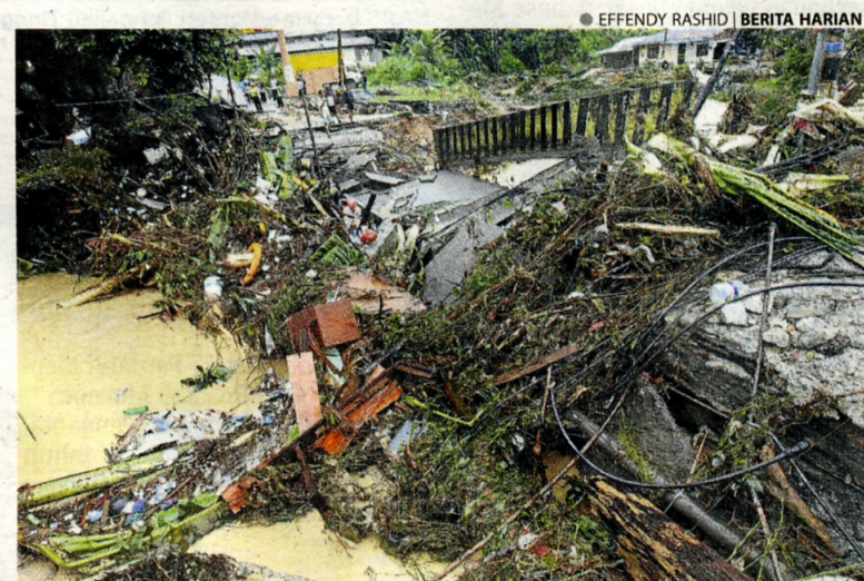
JAMBATAN menghubungkan Kampung Lembah Jaya Utara ke Kampung Bukit Sungai Puteh runtuh akibat banjir, semalam.
