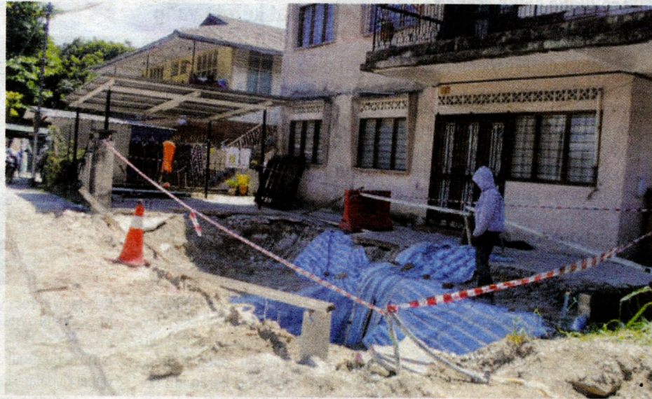
Salah seorang pekerja di lokasi mendapan sedang menjalankan kerja-kerja membaiki pulih selepas JPS Wilayah Persekutuan Kuala Lumpur memperoleh kebenaran daripada penduduk.
