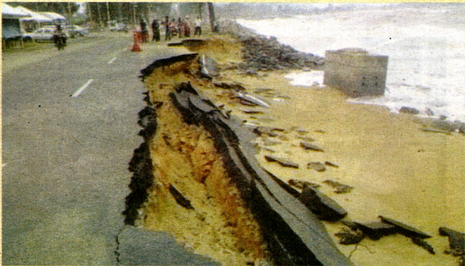
SEBAHAGIAN jalan di Pantai Telok Lipat, Dungun rosak teruk akibat hakisan pantai kerana dilanda fenomena ombak besar. - [LANTLKL14:BHA05169]
