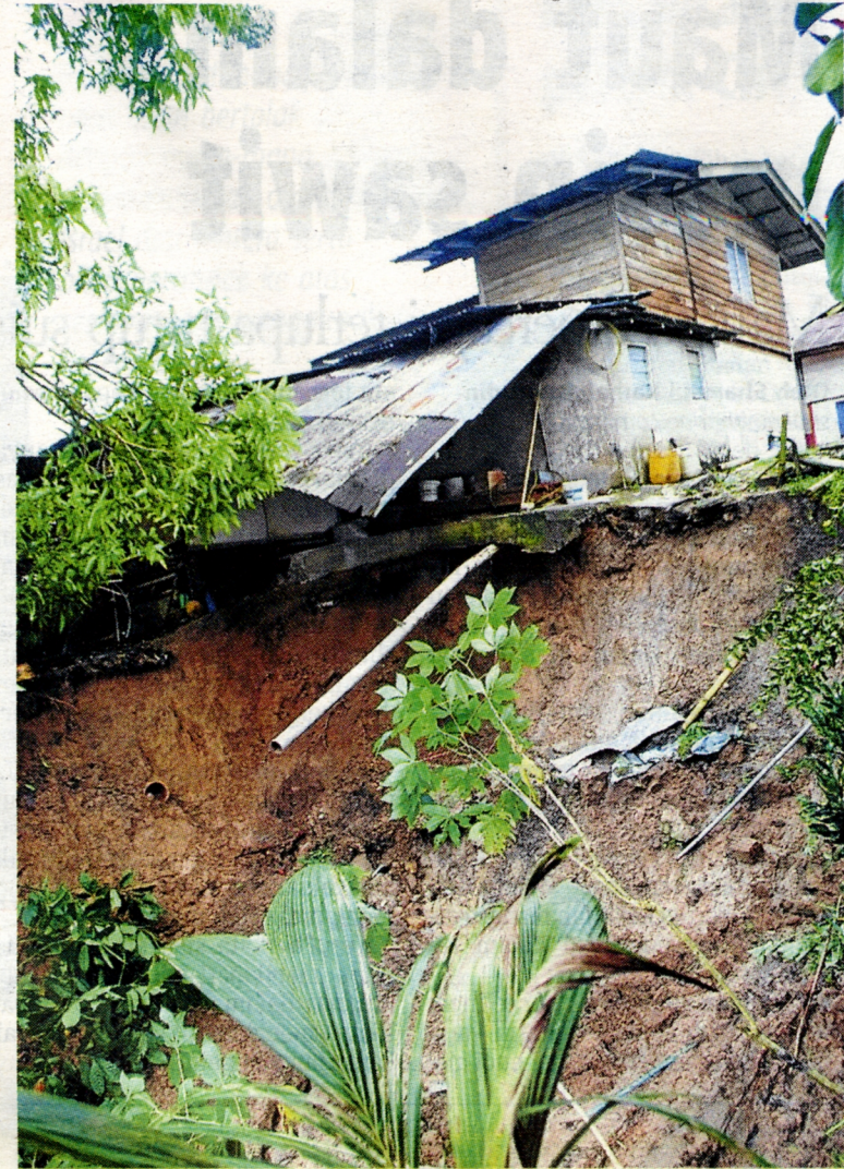
KEADAAN tanah runtuh di belakang rumah Sarus Jait di Kampung Danu, Jalan Puncak Borneo.
