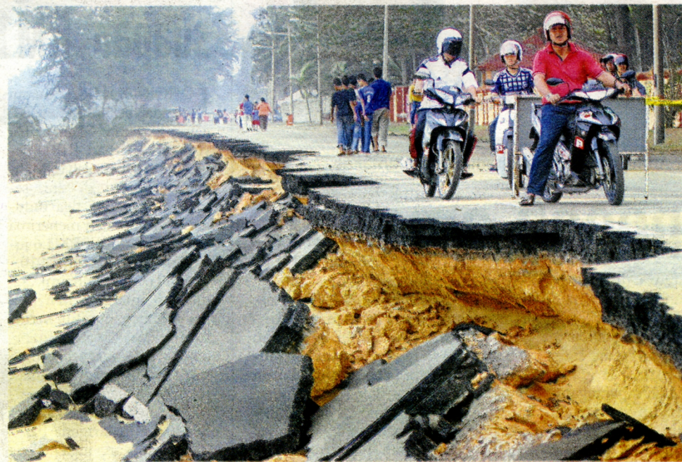
ROSAK...hakisn teruk di Pantai Teluk Lipat akibat fenomena air pasang besar.
