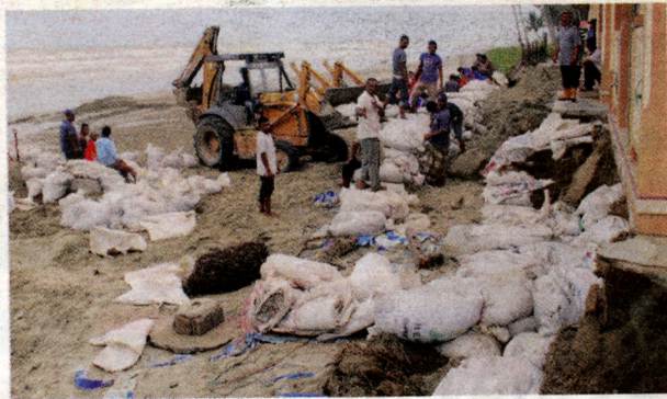
Guni berisi pasir diletakkan sebagai benteng mengelak rumah penginapan di Tanjung Chat Beach Resort, Bachok, runtuh.
