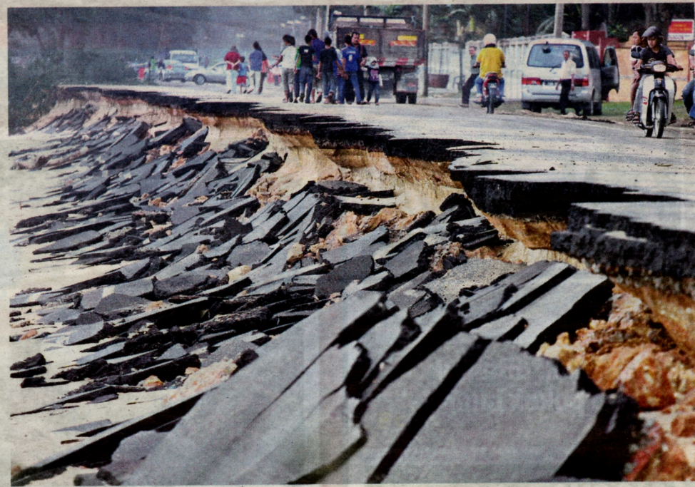
ORANG ramai melihat sebahagian daripada Jalan Teluk Lipat, Dungun yang terpaksa ditutup selepas runtuh dilanda air pasang besar semalam.
