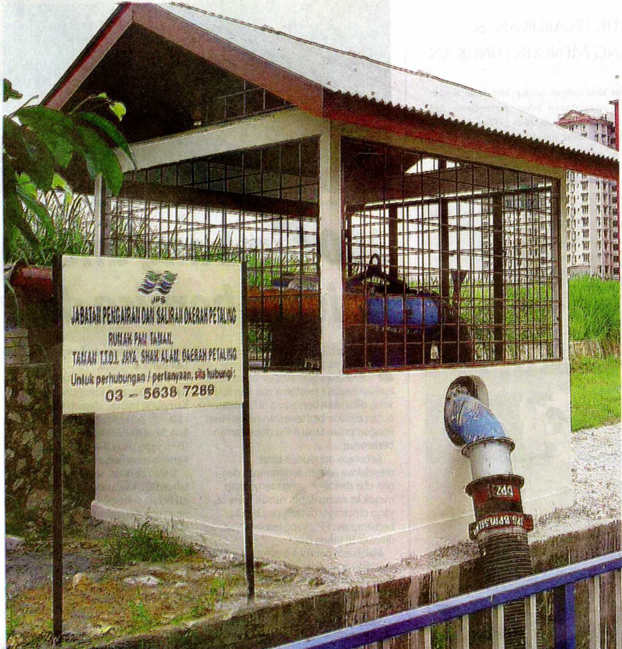
SEDUT: Pam bergerak yang ditempatkan sementara berdekatan Pangsapuri Ilham di Taman TTDI Jaya sementara menunggu stesen pam kekal siap.
