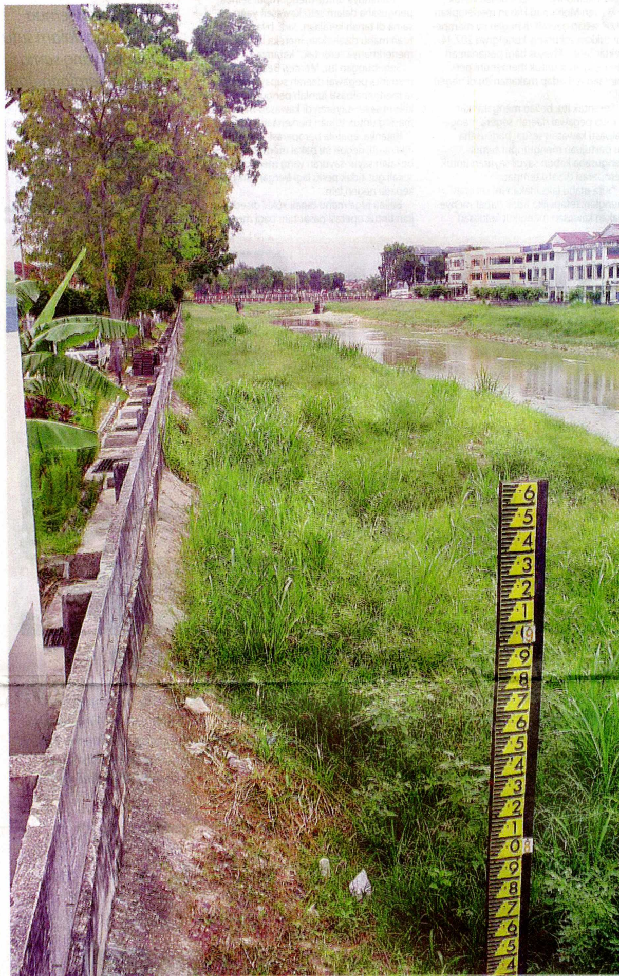
HALANG: Tembok penghalang banjir setinggi 8.5 meter yang akan ditinggikan kepada 9.5 meter bagi menghalang air sungai melimpah ke kawasan perumahan.
