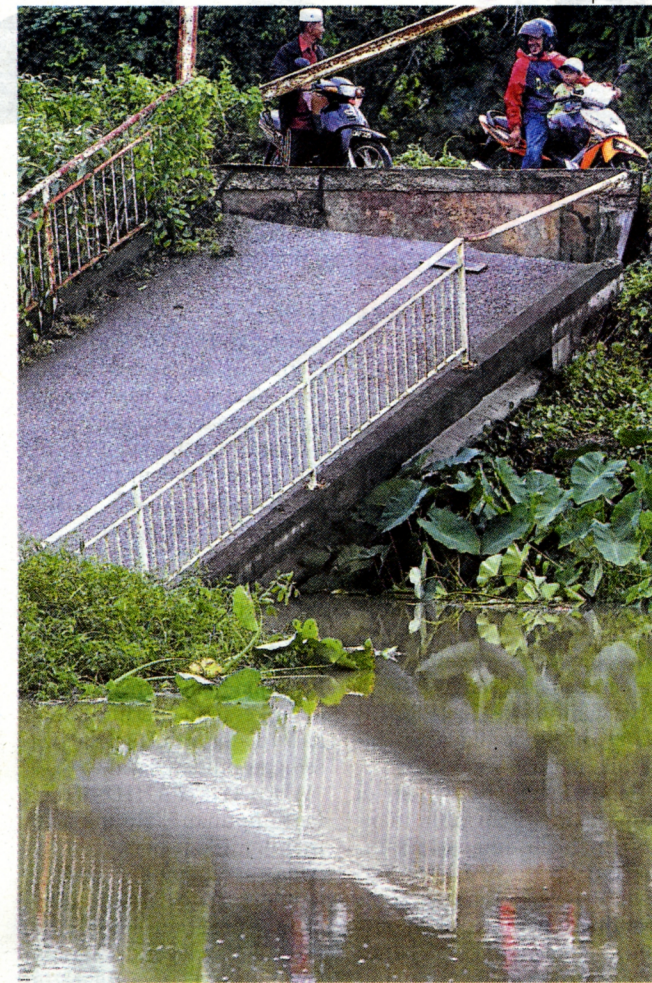
RANAP..jambatan Kampung Kuau runtuh akibat arus sungai deras.
