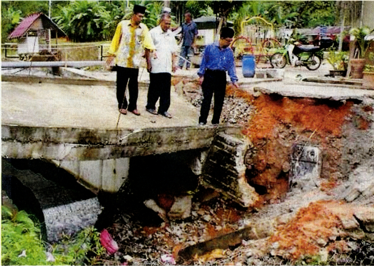
AZMI Che Hussin melihat keadaan sebuah titi yang runtuh akibat hakisan tebing di Kampung Batu Tujuh Rambong, Baling, Kedah, semalam.
