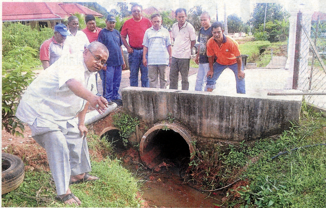
BAKAL DIATASI...Md Yunos (kiri) melihat saluran longkang yang bakal digali.
