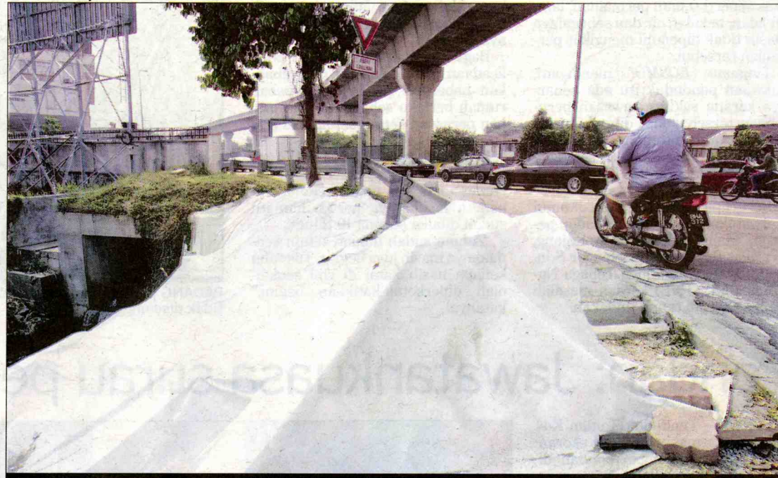
TEBING sungai ditutup dengan plastik bagi mengelakkan kejadian tebing runtuh semakin teruk di tapak projek papan tanda di Jalan SS25/29, Petaling Jaya.
