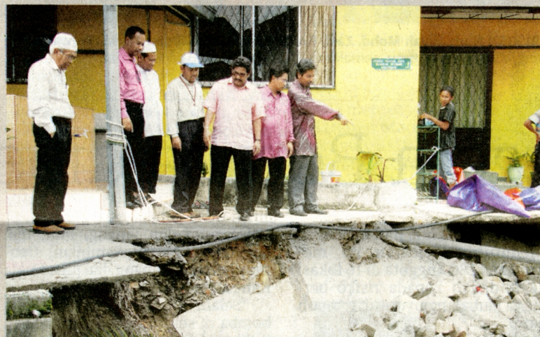
SUBAHAN Kamal (tiga dari kanan) meninjau keadaan kaki lima surau Hidayatul Mustaqim yang runtuh di Bandar Baru Selayang, baru-baru ini.
