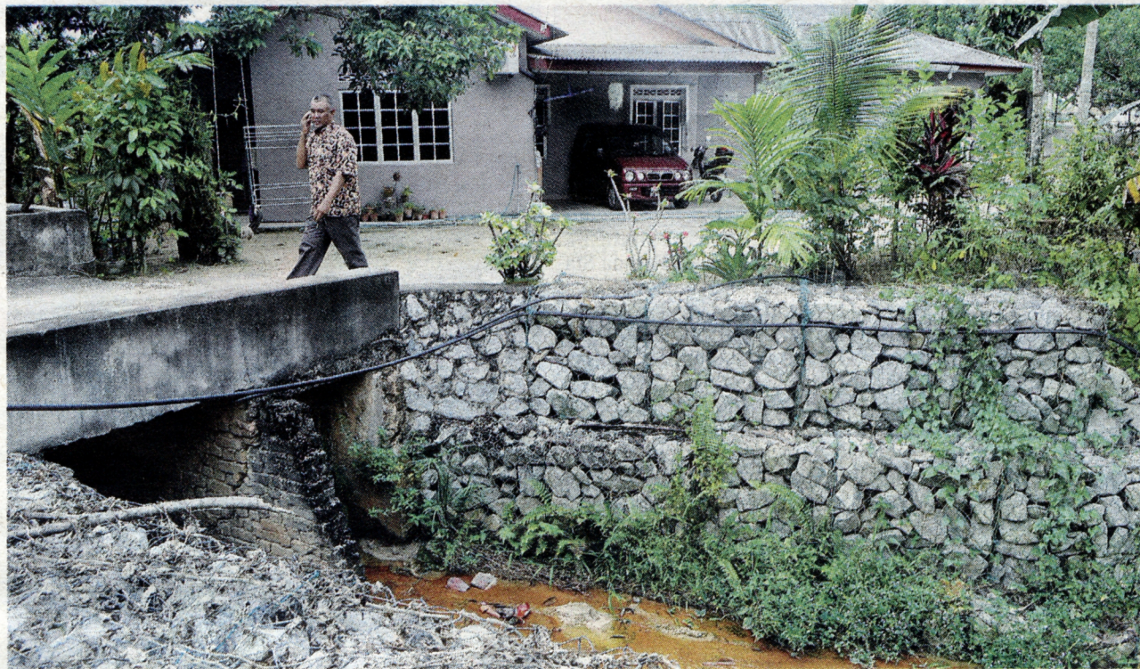
KEADAAN sistem perparitan yang tidak diselenggara di Kampung Limau Manis.
