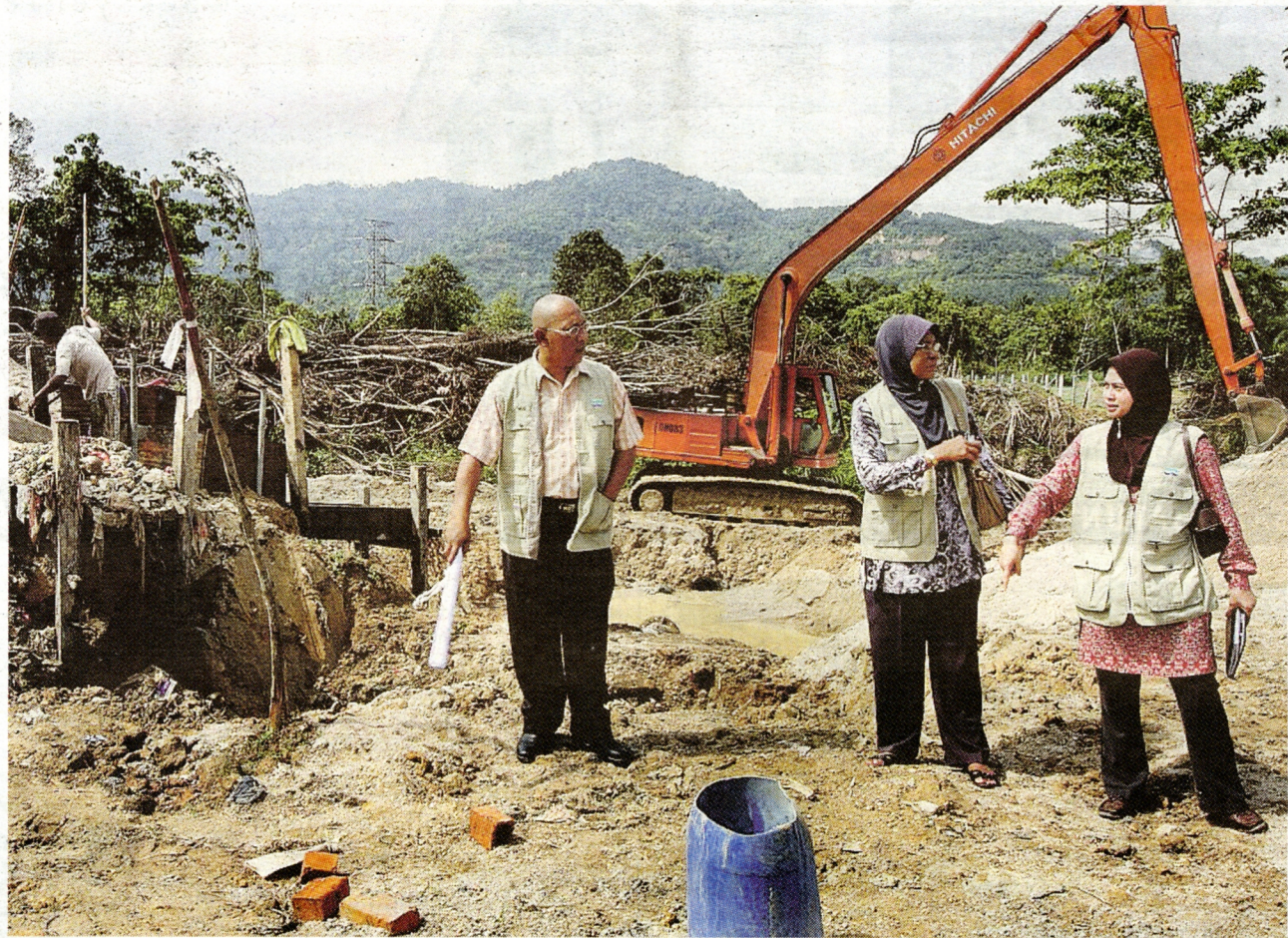
PEGAWAI PTD membuat pemeriksaan ke tapak mengorek pasir di Sungai Pajam di Kampung Gebok, Mantin yang didakwa tidak mengikut peraturan sehingga menjejaskan kualiti air dan menyebabkan hakisan tebing sungai.
