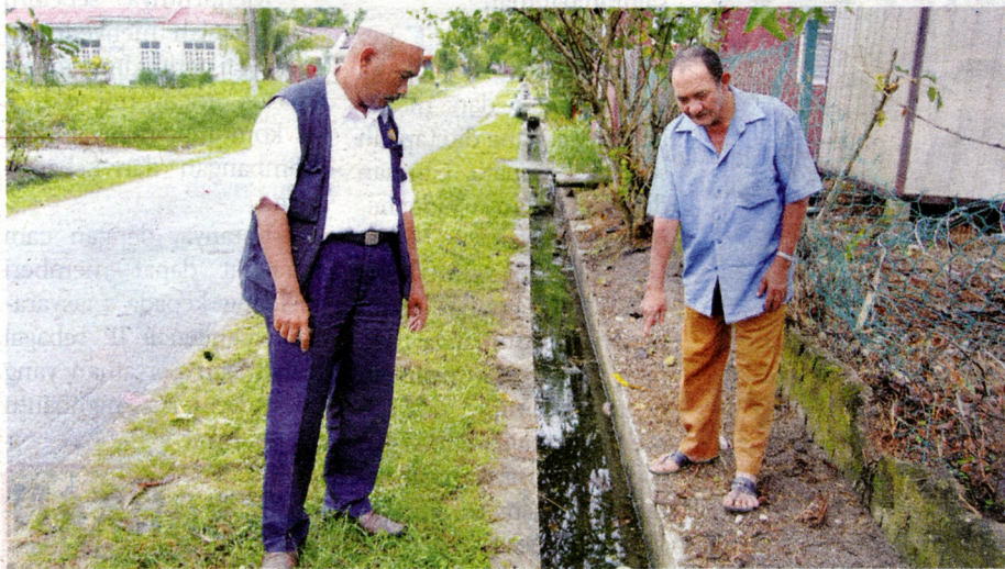
■ Penduduk menunjukkan longkang yang tersumbat menjadi punca banjir kilat berlaku setiap kali hujan lebat di Kampung Baru Kundang.
