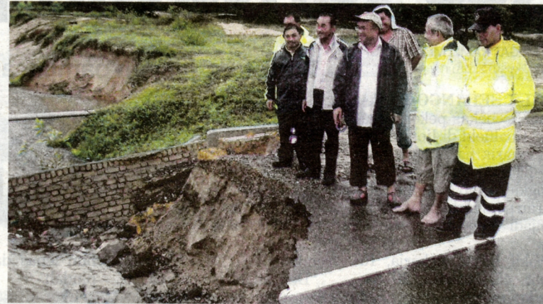
AHLI Dewan Undangan Negeri Kemasik, Ir. Rosli Othman (tiga dari kanan) meninjau jalan runtuh akibat banjir di Jalan Kuala Terengganu-Kuantan di Kemaman semalam.
