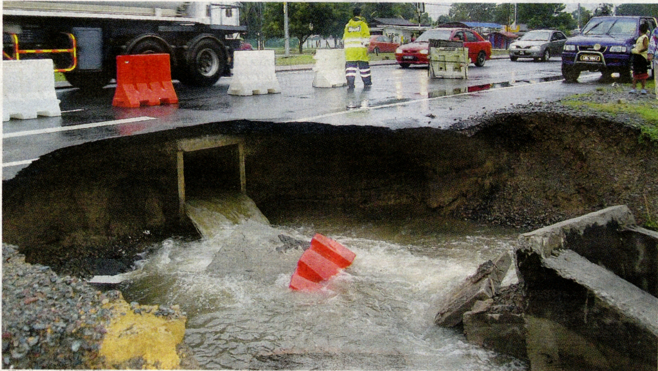
KEADAAN jalan utama Kuala Terengganu-Kuantan yang mendap akibat banjir di Kerteh, semalam.
