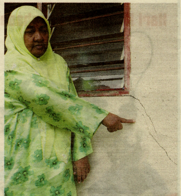
RETAK...Robiah menunjukkan rumahnya yang retak akibat hakisan tanah di belakang rumahnya.
