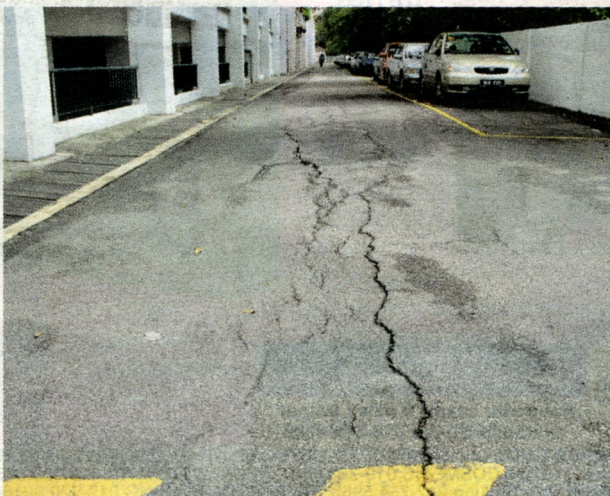
■ Keadaan jalan yang retak didakwa akibat runtuhnya tebing.
