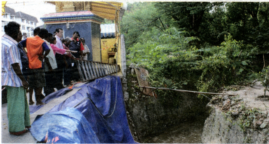
■ Tee Keat (lima, kiri) melawat kejadian tembok runtuh di salah sebuah kuil di Pandan Jaya.
