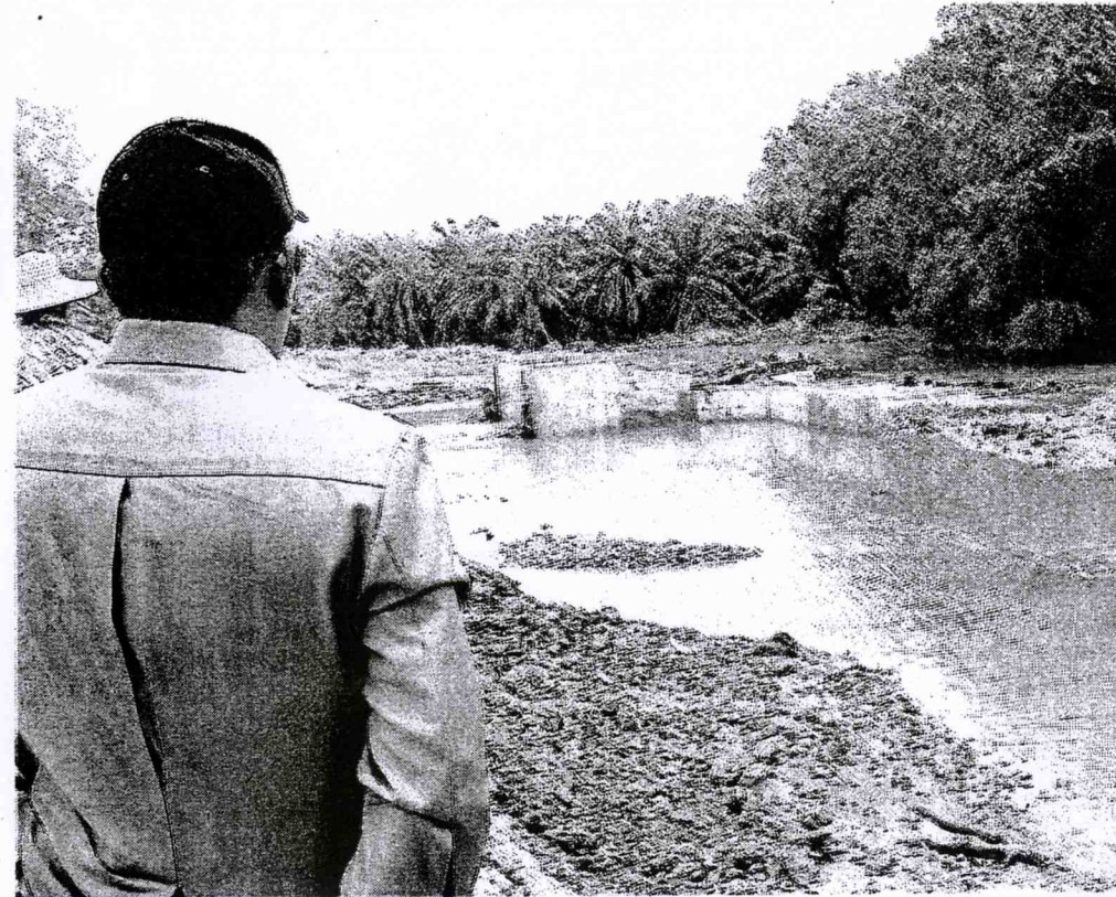
ABD. Rahman Palil meninjau kawasan benteng pecah yang menyebabkan kerugian kepada penduduk Kampung Perepat Batu 18, Kapar, semalam.
