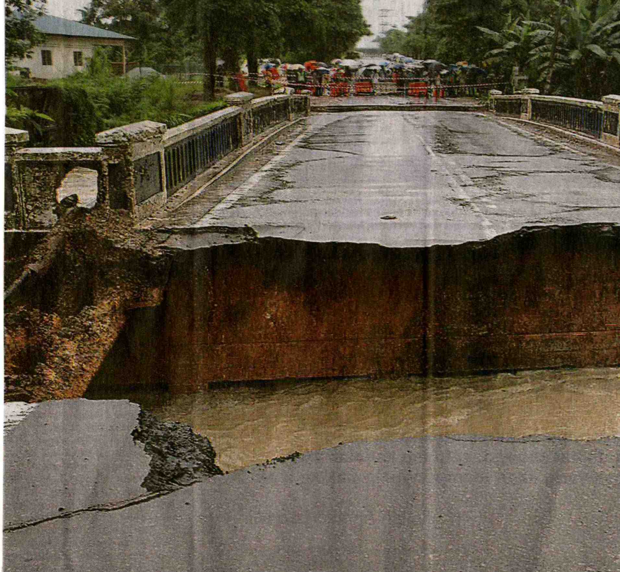
ARUS deras merobohkan jambatan Sungai Semberong yang terletak berhampiran Kampung Sri Cahaya mengakibatkan hubungan jalan raya di antara Kluang dan Mersing terputus akibat banjir yang melanda daerah Kluang, Johor, semalam. [ Lagi berita, gambar di muka 3, 12 dan 13 ]
