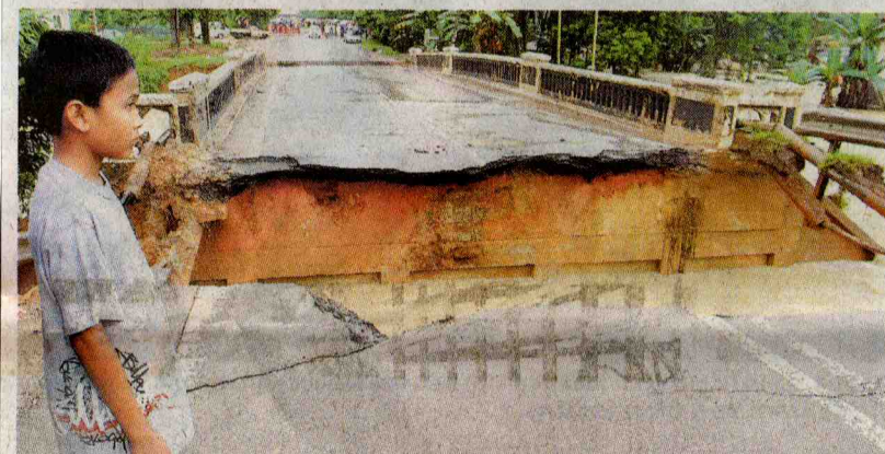
PUTUS DUA: Faris Hadi Mat Diah hanya mampu melihat pangkal jambatan Sungai Sembong Kecil di Kampung Sri Cahaya, Kluang yang runtuh akibat arus deras.
