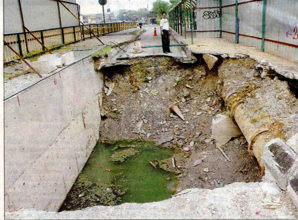
BEGINILAH besarnya lubang di Jalan Cheras yang terbiar tanpa papan tanda amaran serta pagar.
