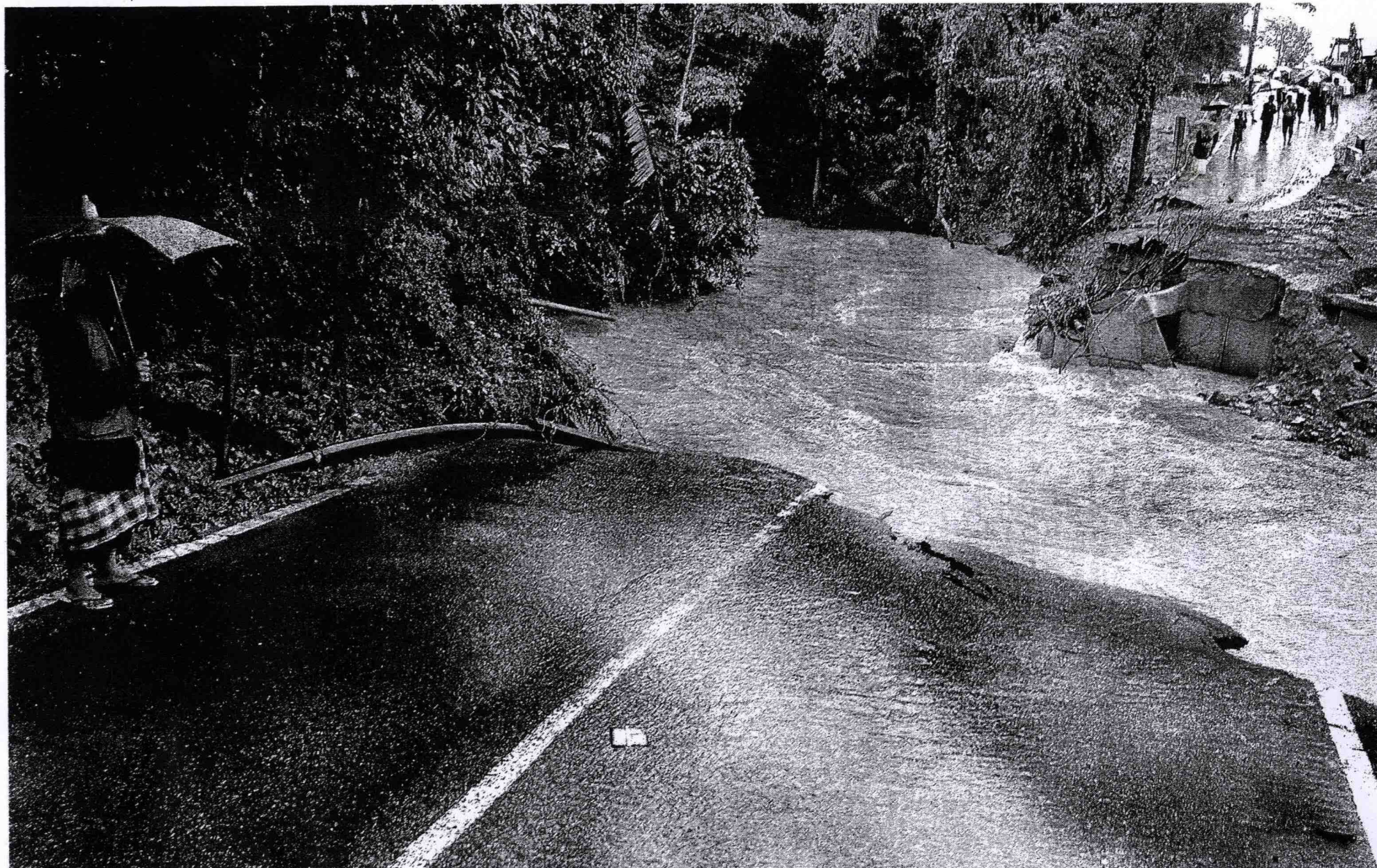
TERPUTUS HUBUNGAN... Jalan utama ke Kampung Dura terputus apabila jambatan yang menghubungkan kawasan itu runtuh dilanda air deras Sungai Dura akibat hujan lebat berterusan di Hulu Terengganu, Terengganu, semalam.
