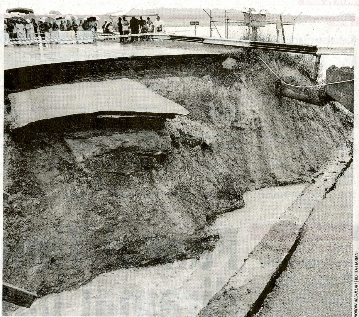
HUBUNGAN TERPUTUS: Jalan berhampiran Jambatan Selancar runtuh akibat arus deras Sungai Pukin menyebabkan 30,000 penduduk terputus perhubungan.
