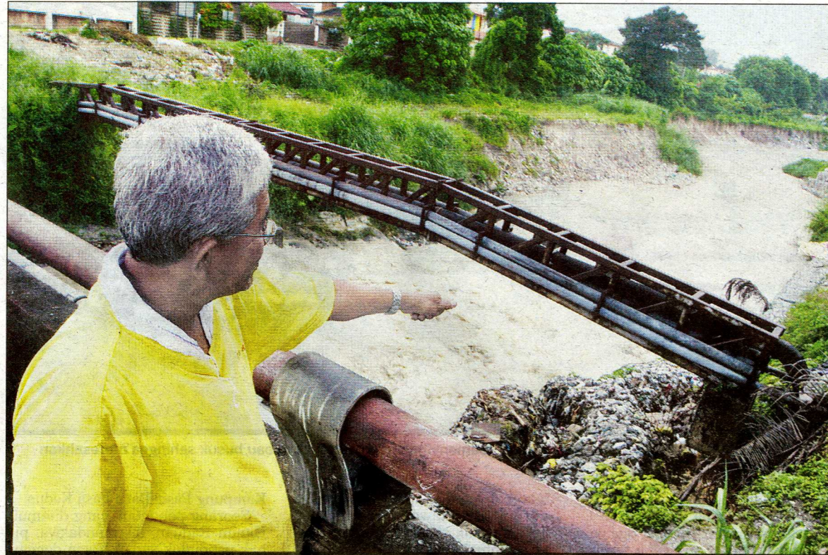
YAHAYA menunjukkan kabel elektrik dan batang paip air yang ‘tergantung’ merentasi Sungai Kayu Ara, Damansara.
